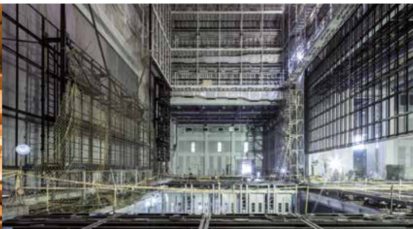
Het toneelhuis van de operazaal in aanbouw. Binnenkort laten enorme podiumliften hier met hoge snelheid een decor van vijftien bij zestien meter tot min veertien meter zakken.
